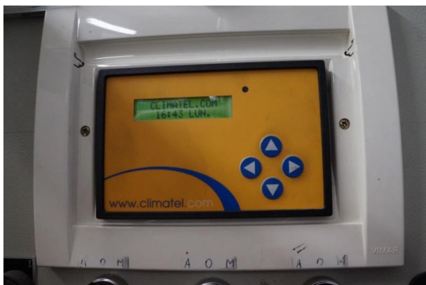
Figura 4.8 – Particolare della centralina climatica situata all’interno della centrale termica a servizio della Scuola Media
