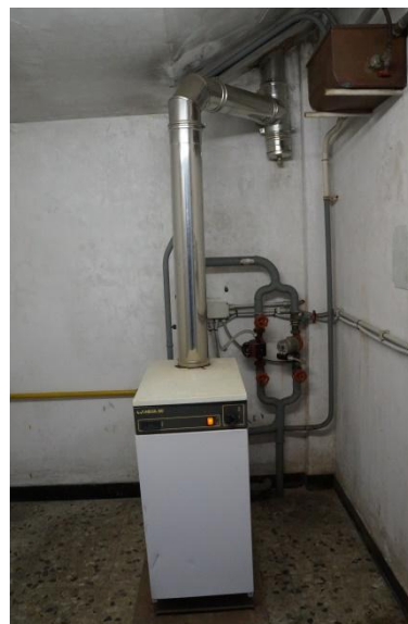
Figura 4.16 - Particolare del generatore di calore a servizio della Scuola Vespertina
