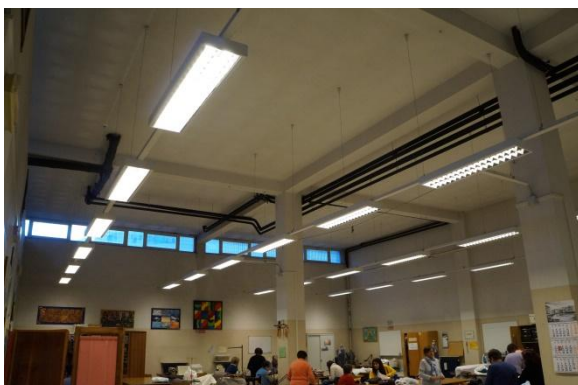
Figura 4.21 - Particolare dei corpi illuminanti ubicati all'interno della Scuola Vespertina
