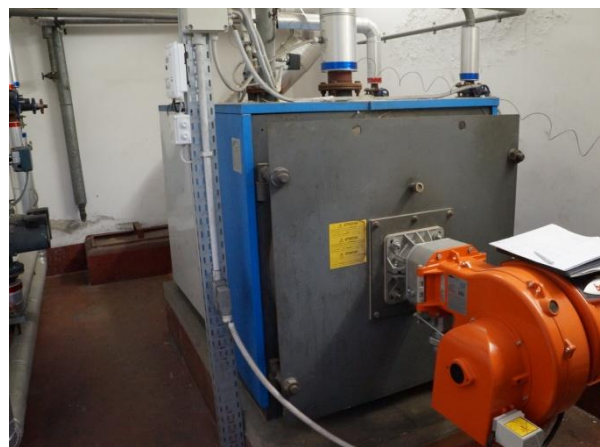
Figura 8.3 – Particolare della centrale termica
