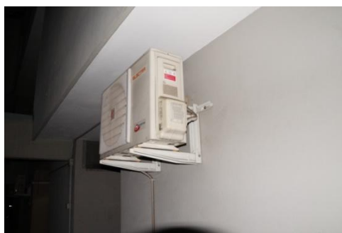
Figura 4.19 - Particolare del sistema monosplit
