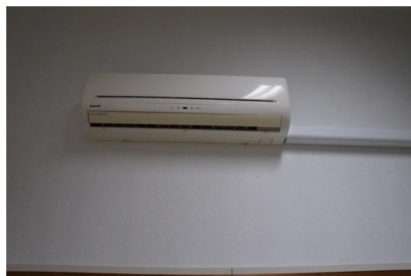
Figura 4.17 - Particolare di uno split installato a parete all'interno di un ufficio
