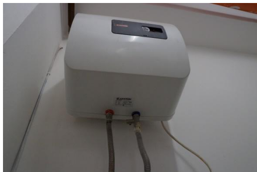
Figura 4.18 - Particolare del un boiler elettrico per la produzione di acqua calda sanitaria
