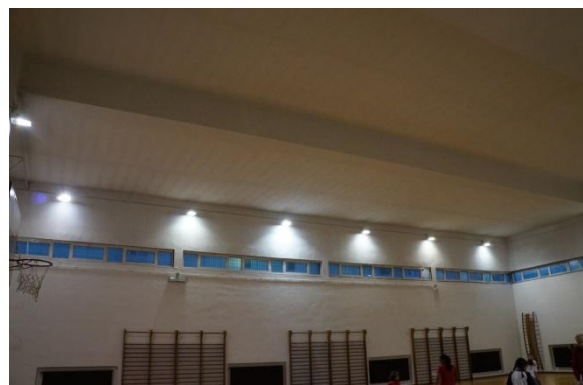
Figura 4.22 - Particolare dei corpi illuminanti ubicati nella palestra
