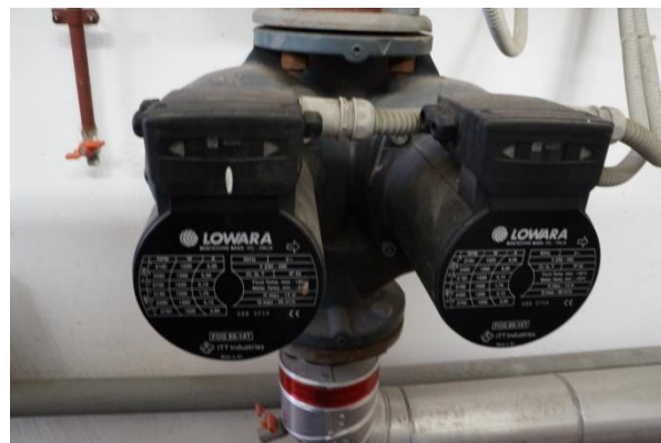
Figura 8.7 – Particolare pompe di circolazione
