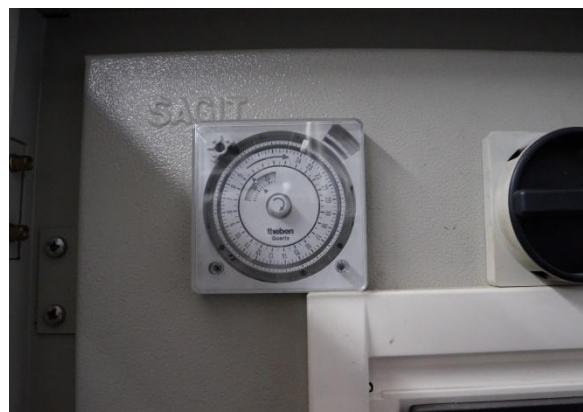
Figura 4.9 - Particolare della centralina di controllo situata all’interno della centrale termica a servizio della Scuola Media
